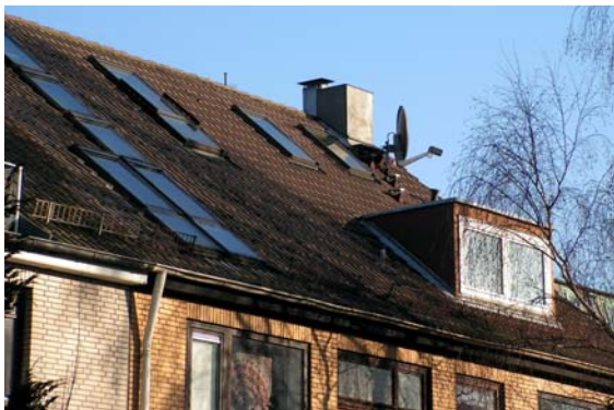
Dachflächenfenster in unterschiedlicher horizontaler und vertikaler Anordnung – das Dach wirkt unruhig und die Fenster reflektieren stark.
