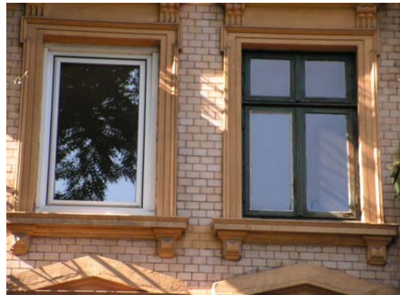
Durch uneinheitliche Erneuerungen der Fenster zerfällt die Fassadenharmonie.
