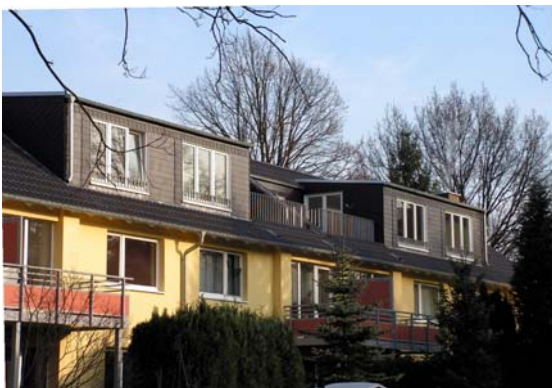
Nicht gelungene Dachterrasse insbesondere in Kombination mit den Dachgauben
