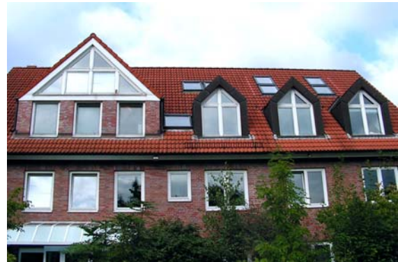
Zu viele unterschiedliche Dachaufbauten und Dachflächenfenster, die ausschließlich an den Belichtungsansprüchen orientiert sind, ohne Abwägung mit der negativen Außenwirkung.
